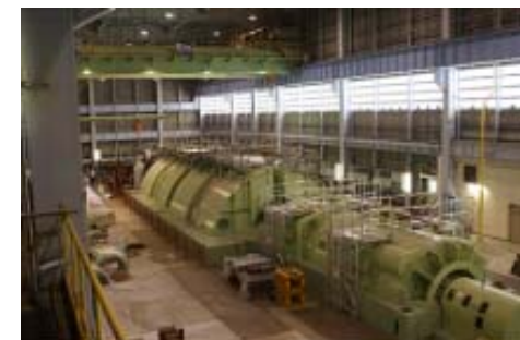
苫東厚真発電所
