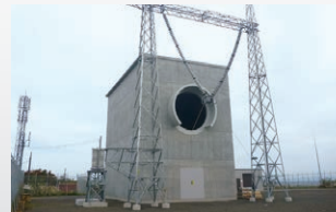
新北本連系設備 ケーブルヘッド（北海道側）
