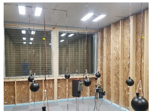
天井放射空調実験室
