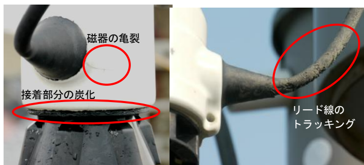
CF遮断器の劣化例
