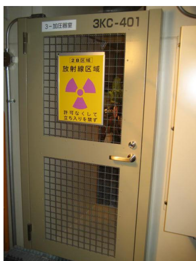
入口扉（施錠管理）
